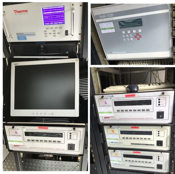
Figura 59. Equipos de medida instalados en la estación La Felguera
