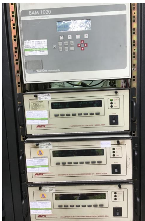
Figura 28. Equipos de medida instalados en la estación Meriñán
