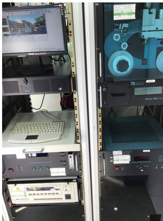
Figura 78. Equipos de medida instalados en la estación Jardines de Juan XXIII
