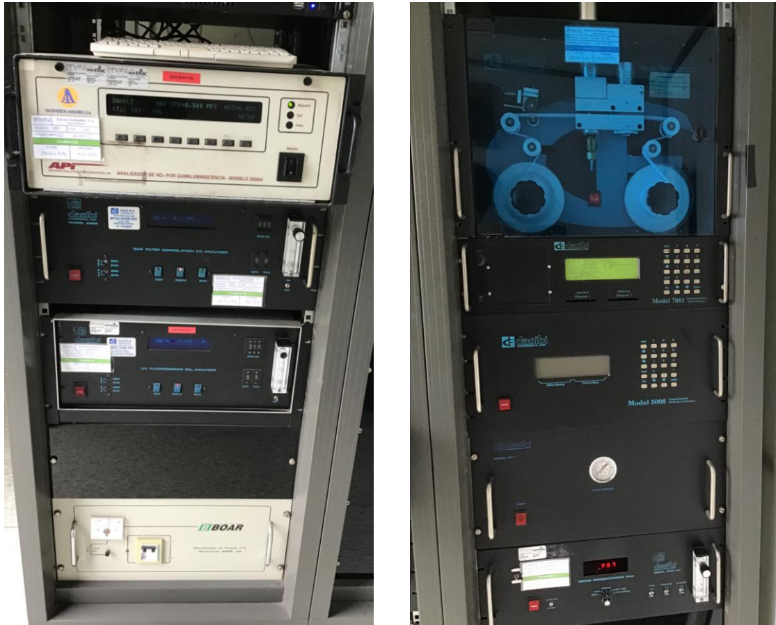
Figura 95. Equipos de medida de la calidad del Aire de la estación Blimea
