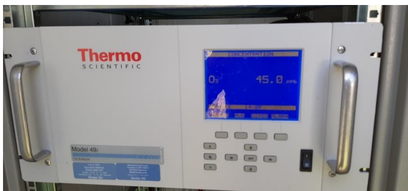
Figura 35. Equipo de medida instalado en la estación Somiedo
