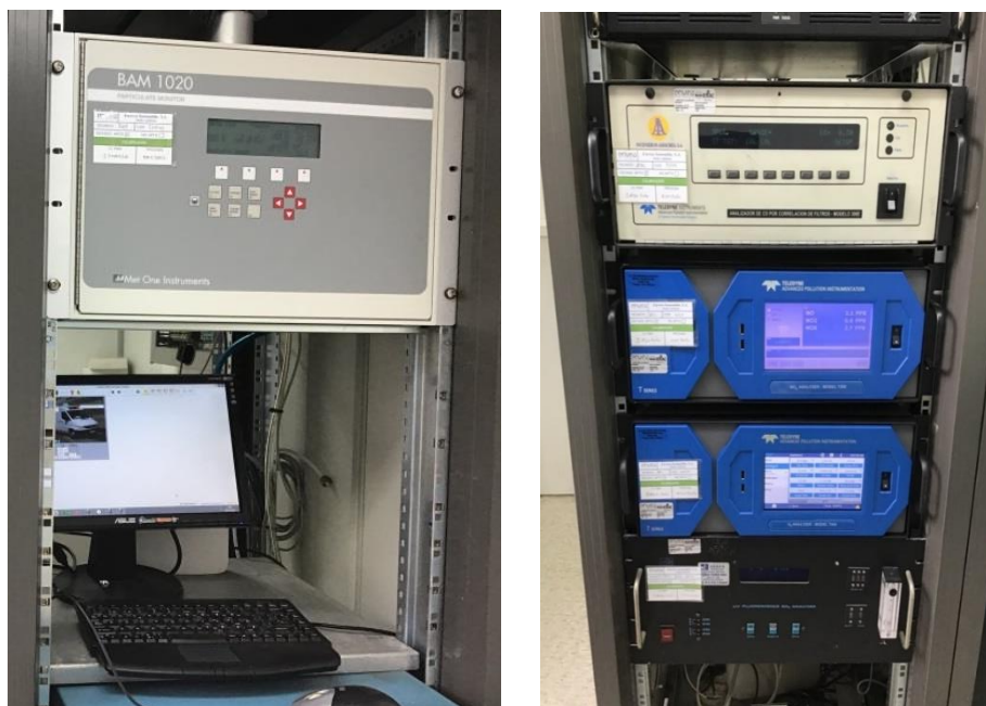
Figura 18. Equipos de medida instalados en la estación Cangas del Narcea
